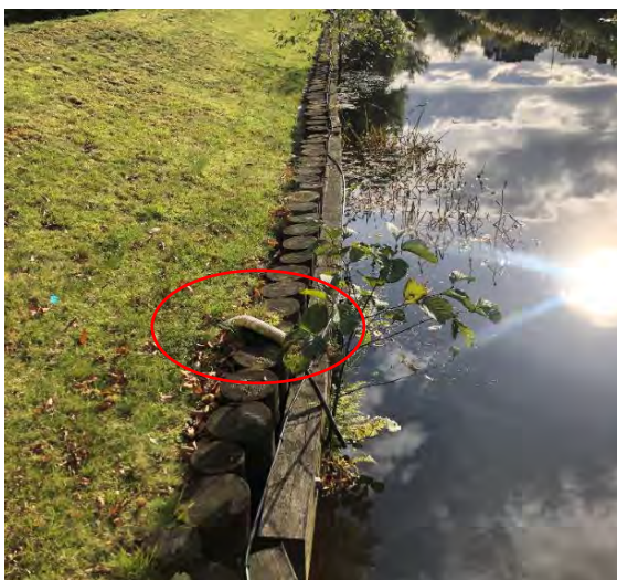
Figur 15. Möjlig dräneringsledning som leder direkt till Mölndalsån i nordvästra kanten av planområdet (Ramboll 2020).
